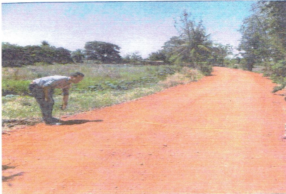
๒. โครงการลงดินถนนลูกรังสายนายนายจักร หมู่ที่ ๓
